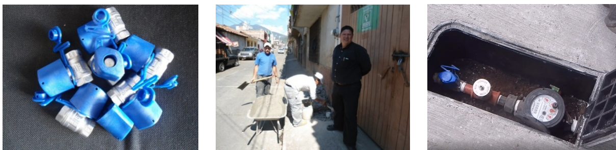
Figura 6 | Válvula antifraude limitadora de caudal suministrada a los 4 OOAPAS ribereños e instalación de las mismas por el propio organismo.
