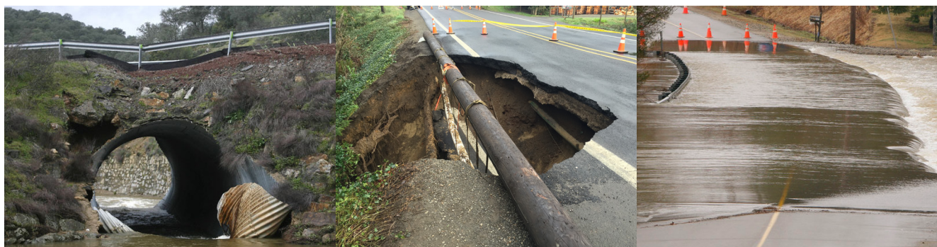
Figura 1 | Ejemplos de corte del servicio en infraestructura fruto del fallo de una obra de drenaje transversal: colapso estructural, sobrevertido por falta de capacidad hidráulica.
