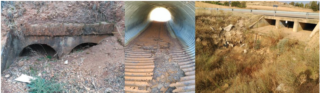
Figura 2 | Ejemplos de patologías tipo o factores de riesgo: obstrucción del conducto/s, deterioro estructural del conducto, signos de erosión local bajo las embocaduras.
