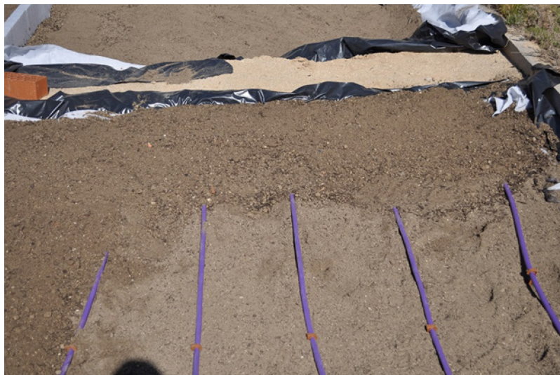
Figura 1 | Instalación de riego por goteo subsuperficial
