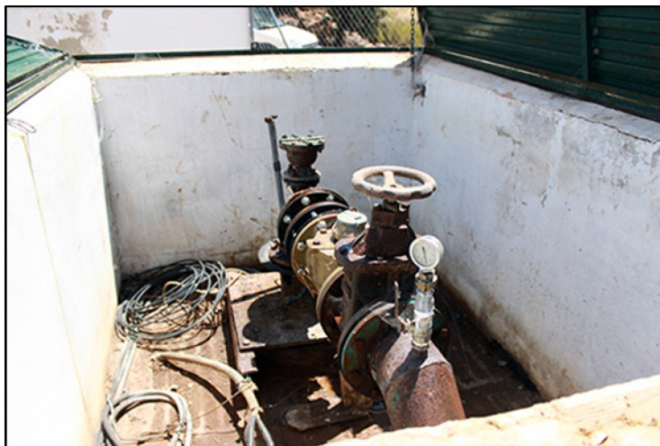
Figura 2 | Bomba del sondeo
