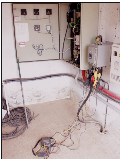
Figura 4 | Cuadro eléctrico de la bomba del sondeo y equipo de medición
