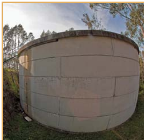
ETAP do Fontenlo (Coirós)
