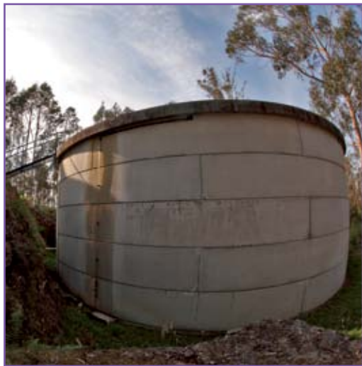
ETAP do Fontenlo (Coirós)
