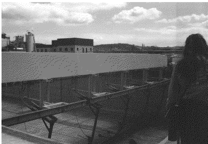
Decantador rectangular con puente de rasquetas.
