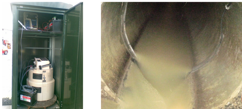
Figura 2: Sección de control (izq.) e instrumentación instalada en el colector (dcha.).
